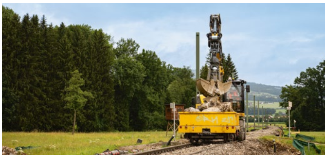
Für die Erneuerung der Lokalbahnstrecke im Raum Siggerwiesen musste im Sommer die Oberleitung vorübergehend demontiert werden.
